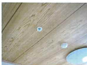
全室スプリンクラー完備 …万全の防火対策を 実施しております。
